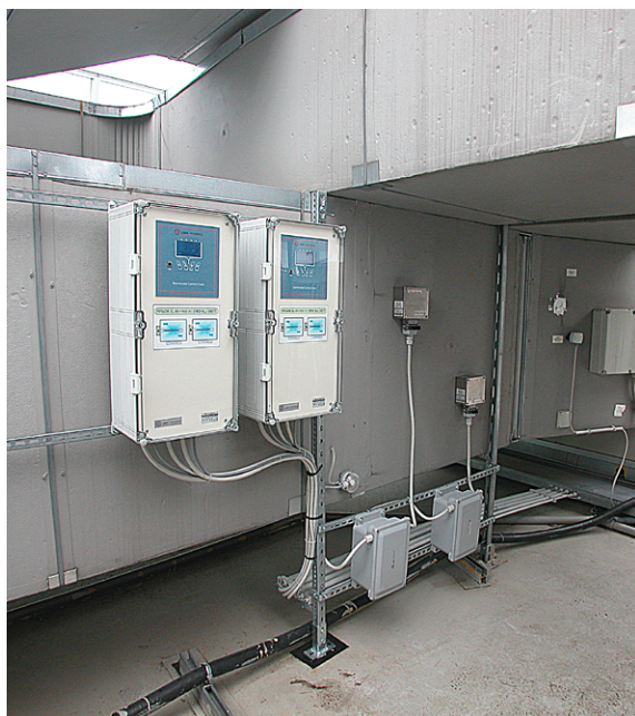
Supply box e apparecchi installati
